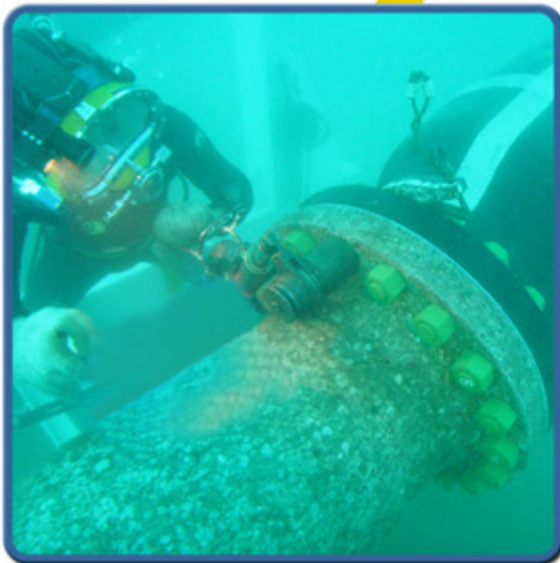
ジャンパーホースとPLEM (パイプ・ライン・エンド・マニフォールド*) *Pine Line End Manifold
