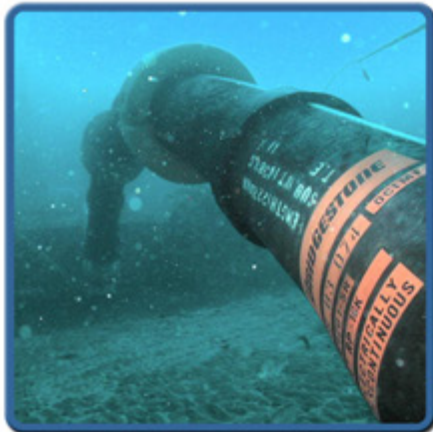
ジャンパーホース(PLEMとフルイドスイベルをつなぐもの)の設置
