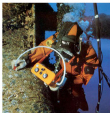
非破壊検査 (水中肉厚測定)
