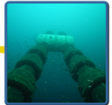
サブマリンホース(フローティングホースとフルイドスイベルの間)の設置
